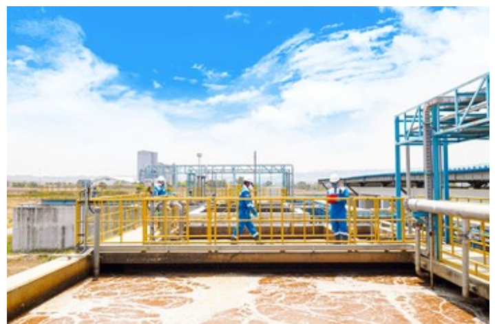
DES Iの水処理施設の処理能力は1日当たり100立方メートル
